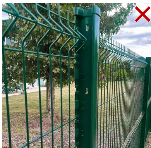
Clôture en grillage rigide
